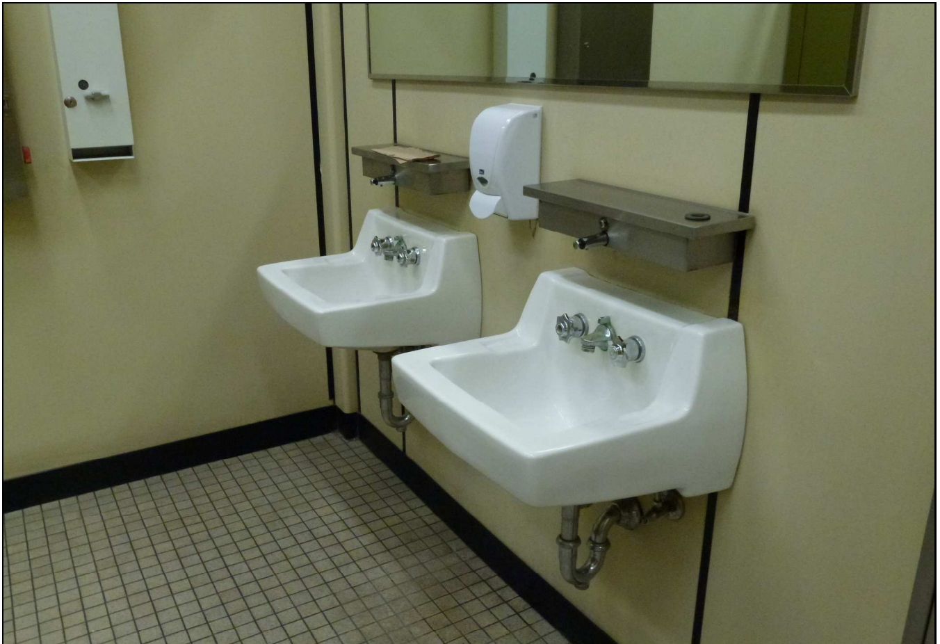
14. Elkhart Courts Bldg Sinks
